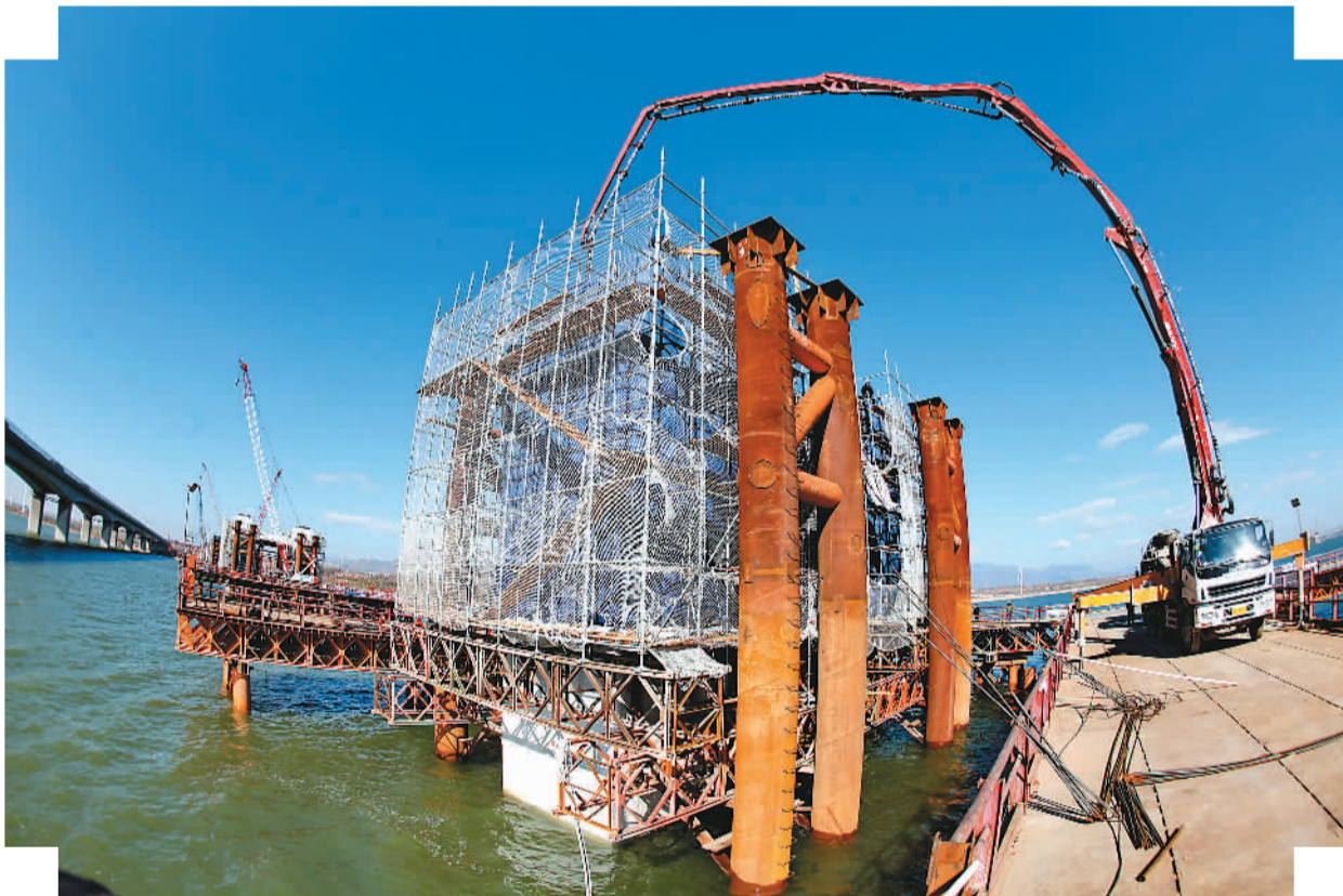
近日，新建京（北京）张（张家口）铁路官厅水库特大桥正在加紧施工。据介绍，该特大桥是新建京（北京）张（张家口）铁路重要节点工程，全长9077米，主桥采用8跨110米的变截面钢桁梁跨越官厅水库。目前，大桥主桥129根桩基和9个主桥墩承台已全部完成。
