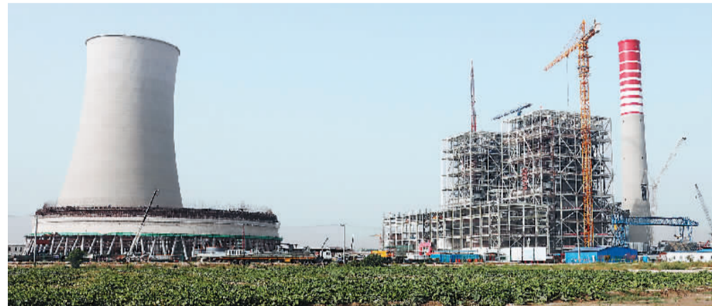
中巴经济走廊首个能源项目——华能巴基斯坦萨希瓦尔燃煤电站。
