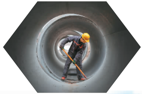
施工人员在南水北调通州支线工程施工现场清理淤泥。新华社记者 高键钧摄
