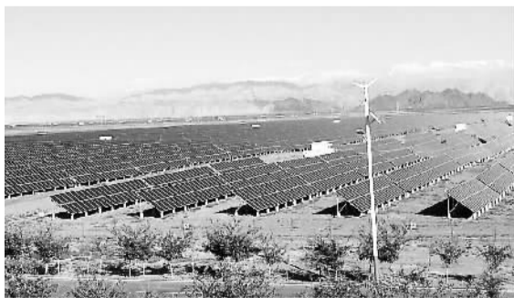
图为建设银行哈密分行贷款支持的华能光伏电厂项目。
