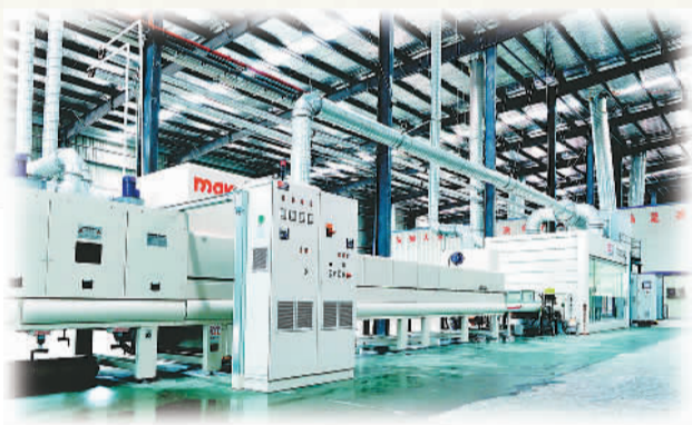
机器人喷涂线
