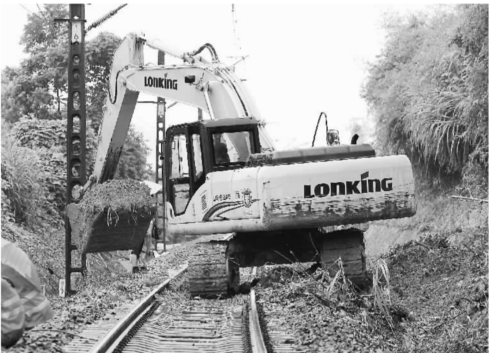
受8月19日晚强降雨影响, 福建顺昌县境内的鹰厦铁路沿线发生5处塌方, 造成铁路通行中断。目前, 南昌铁路部门和顺昌县委有关部门正组织人员进行抢修。图为8月20日, 施工人员在顺昌县城内鹰厦铁路塌方路段清理路基上的泥土。 陈柏材摄(新华社发)
