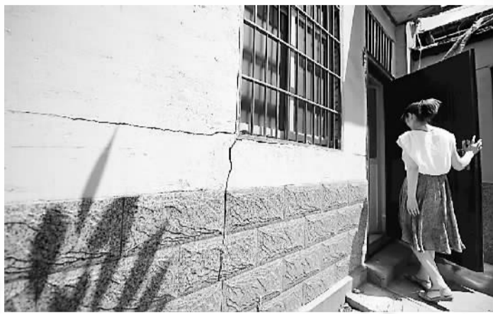
灵寿县委大院一处裂缝的墙体 新华社记者 王晓摄
