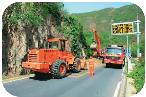
门头沟区近日举行公路沿线山体塌方防汛演练，确保安全度汛。 千龙网发
