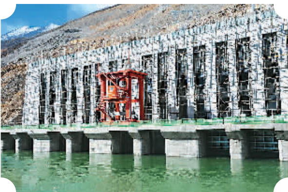
图为西藏旁多水利枢纽工程装机室外景。
