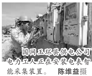
国网玉环县供电公司电力工人正在安装电表智能采集装置。陈维益摄
