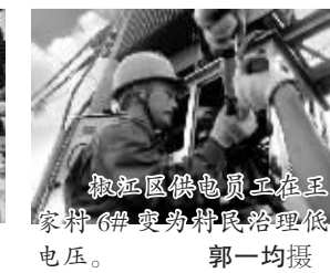
椒江供电员工正在在家村6#变旁帮民修理低压电压。郭一均摄
