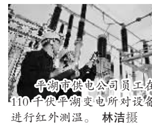
平湖市供电公司员工在110千伏平湖变电所对设备进行红外测温。林洁摄
