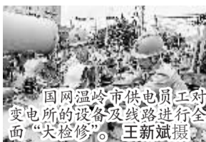
国网温岭市供电公司变电所的设备及线路进行全面“大检修”。王新斌摄
