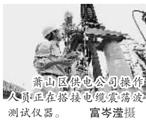
萧山区供电公司操作人员正在搭接电缆震荡波测试仪器。富岑澹摄
