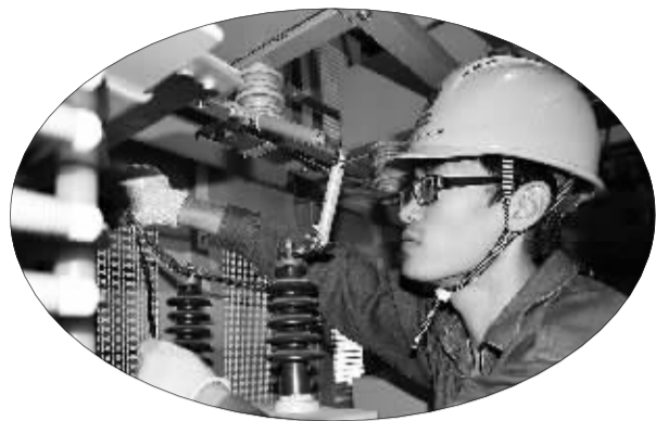
国网浙江桐庐供电公司技术人员正在对110千伏百江变电站室内电容器进行现场维护。薛晓玮摄
