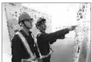
杭州供电公司检修人员为设备做工作许可检查。徐勇摄
