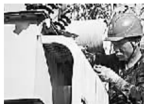
8月11日15时,富阳市鹿山村10千伏3号变电站气温过高,A相设备过热着火。
