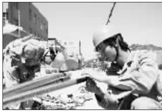
台州路桥区供电公司工作人员在39℃高温下,对苍桥村改造,确保社会可靠供电。曹笑笑摄
