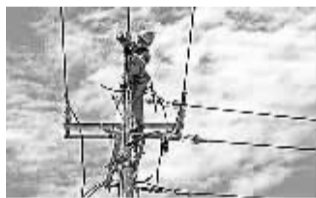
日前，富阳供电局施工人员冒着高温在35千伏永丰临时变电站进行负荷转供、电缆拆装移位等工作。方旭峰 摄
