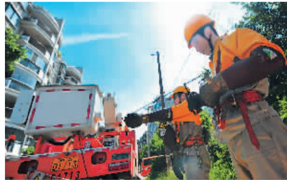
针对近期炎夏高温天气造成的负荷猛增，为保证小区居民正常用电，福州市电业局决定让电力工人们带电作业。图为7月8日9时，电业局的电力抢修工在某小区内准备更换配电网的刀闸。新华社记者 魏培全摄
