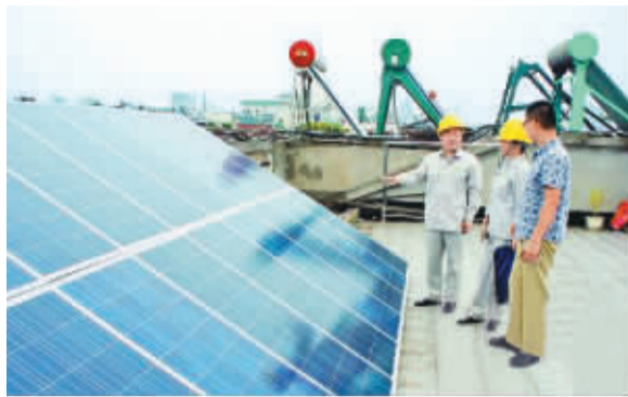
图为电力工作人员在查看刘锐的“家庭光伏电站”。
