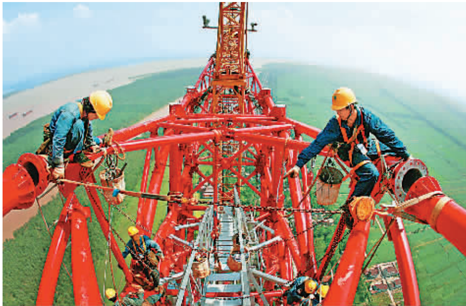
铁塔组立。工作人员在锦苏线长江大跨越铁塔上进行高空(资料照片) 新华社发
