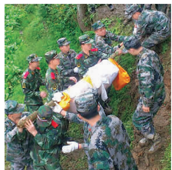
4月22日，贵州省道304线思南青杠坡段发生二次山体滑坡，造成正在抢救的施工人员伤亡，至25日18时，已造成11人死亡、2人受伤。图为武警铜仁支队及思南中队官兵在一线开展救援。邓刚 郭汉祥摄
