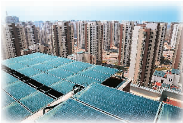
已经竣工的天津市西青区张家窝镇家贤里小区光伏发电项目。 周勤隆摄（新华社发）
