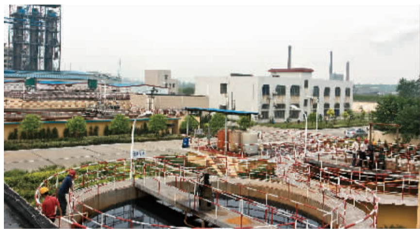
楚源集团近期新建的污水处理设施
