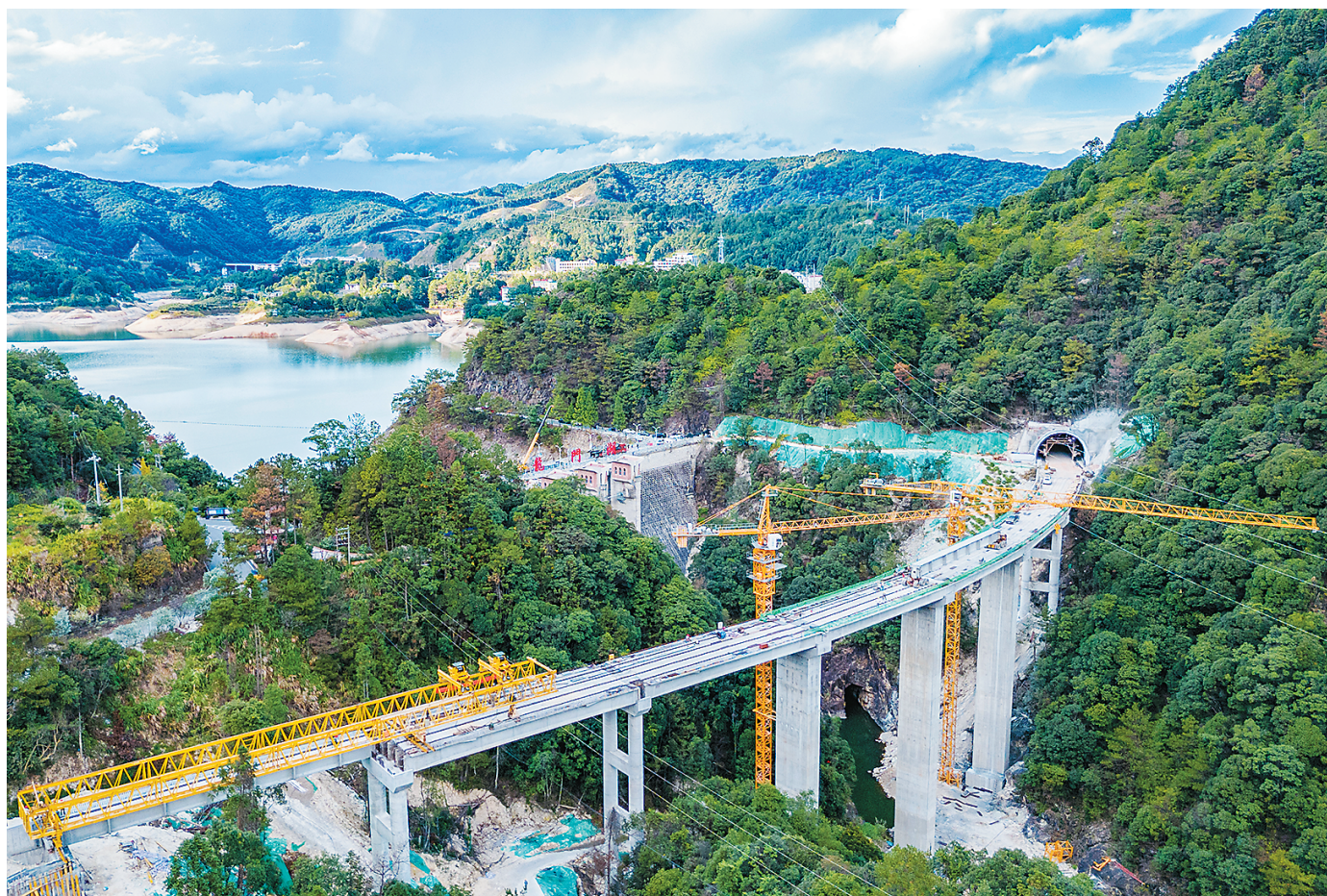
近日,在福建省泉州市德化县X329县道龙门滩一级水库大坝段改线工程施工现场,建设者正在安装预制T梁,相关建设工作有序推进。该工程是福建省重点项目德化县抽水蓄能电站项目的附属配套工程,建成后实现龙门滩水库拦河坝与外部交通分离,保障大坝安全稳定运行,改善沿线路交通出行条件。许华森摄(人民视觉)
