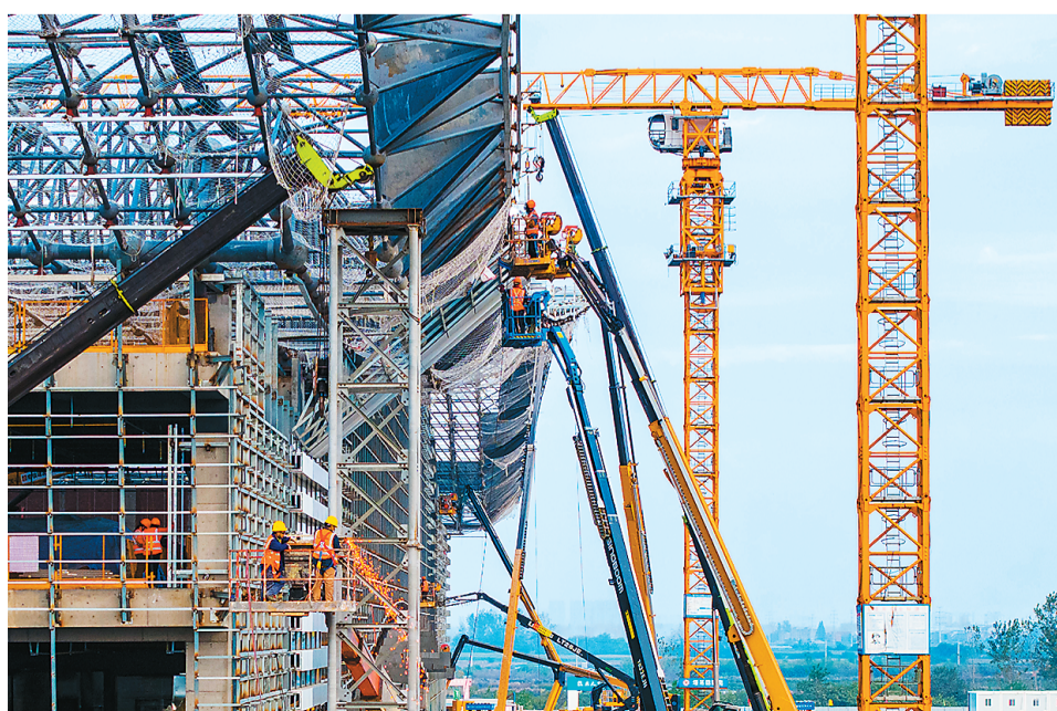
位于湖北省汉川市河东街道的汉川东站工程是沿江高铁通道关键区段之一，也是武汉城市圈城际铁路网的重要组成部分，建成后将成为长江经济带综合立体交通走廊客运骨干节点。总投资约4.1亿元。
