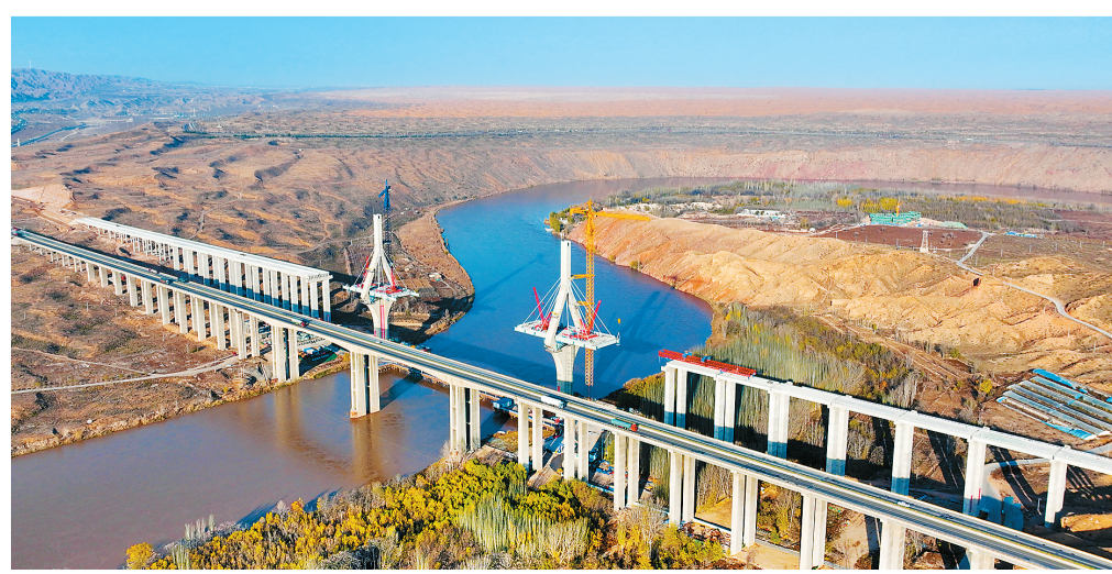
黑山峡黄河大桥位于宁夏回族自治区中卫市沙坡头区,是目前黄河宁夏段建设最高、倾角最大、施工技术最复杂的公路大桥。项目建成后,将进一步完善西北区域公路网络。图为黑山峡黄河大桥建设现场。袁宏彦摄(人民视觉)
