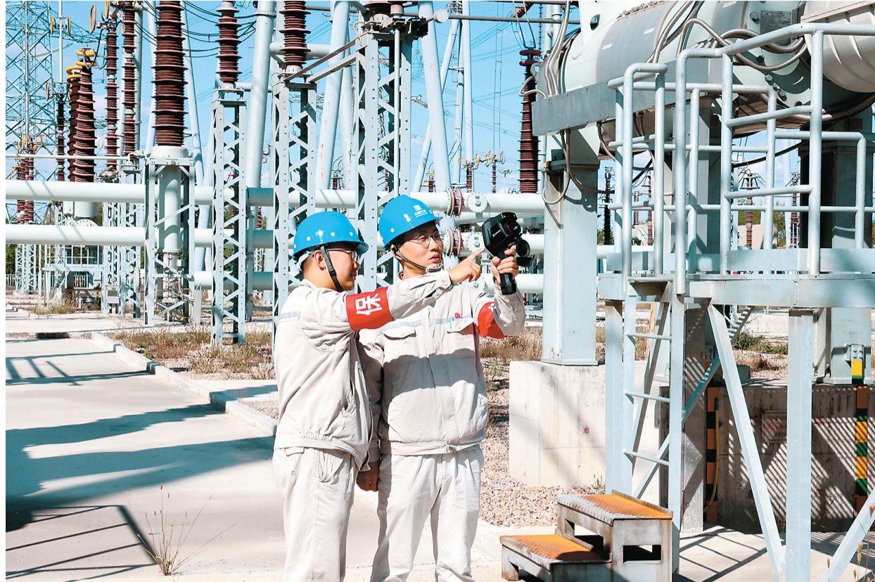
大唐国际托克托发电公司工作人员在检查高压设备。
