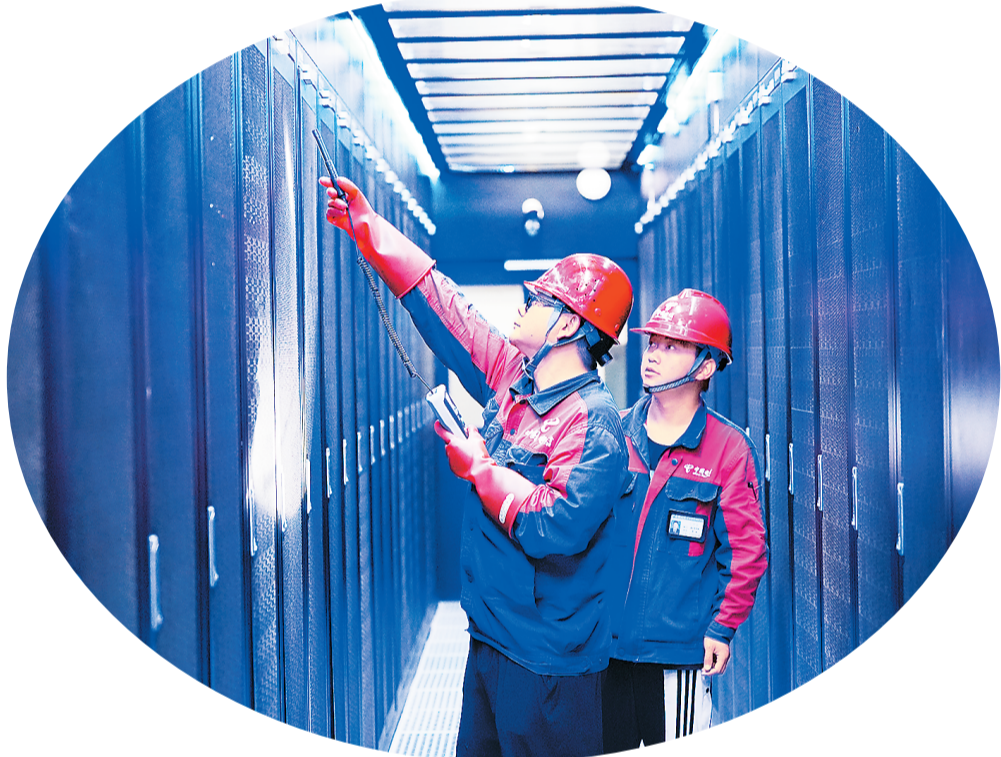
工作人员在东数西算（贵州）智算中心内巡检。
