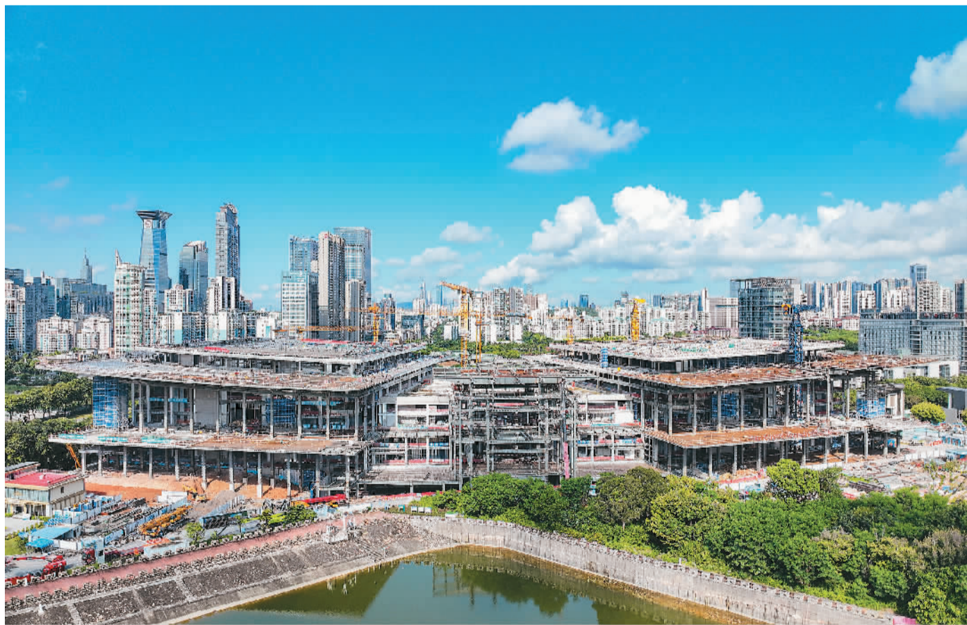
由中建八局承建的深圳国际交流中心（一期）近日完成会议中心主体封顶。深圳国际交流中心是广东省深圳市“一馆三中心”的“中心”之一，建成后将进一步提升深圳承接国际会议的能力，为粤港澳大湾区增添崭新的城市会客厅和靓丽的城市名片。吕立卓摄
