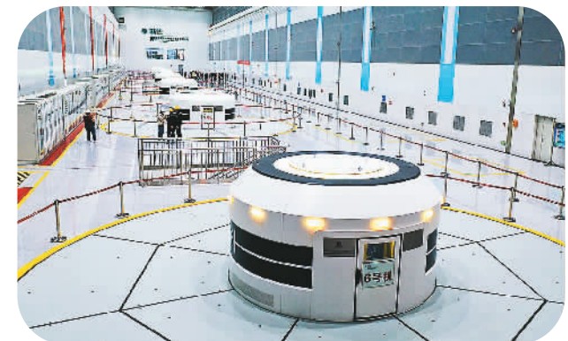
图为位于河北省承德市的国网新源丰宁抽水蓄能电站地下厂房内的可逆式水泵水轮发电机组。
