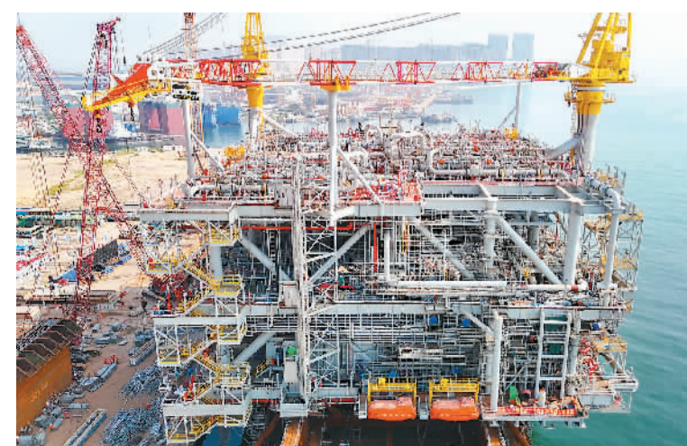
图为马赞油气集输平台。张进刚摄(人民图片)
