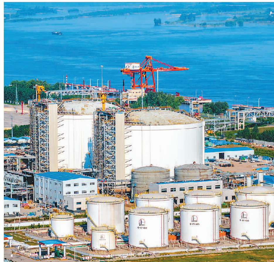
安徽芜湖长江LNG内河接收(转运)站为长三角天然气重要的资源供应点和“气化长江”的LNG加注母站。项目建成运营后，将对规模化推广LNG在水运行业应用、增强长江经济带船舶污染防治能力、加快推进长江绿色航运发展具有重要示范和引领作用。图为该项目现场。
