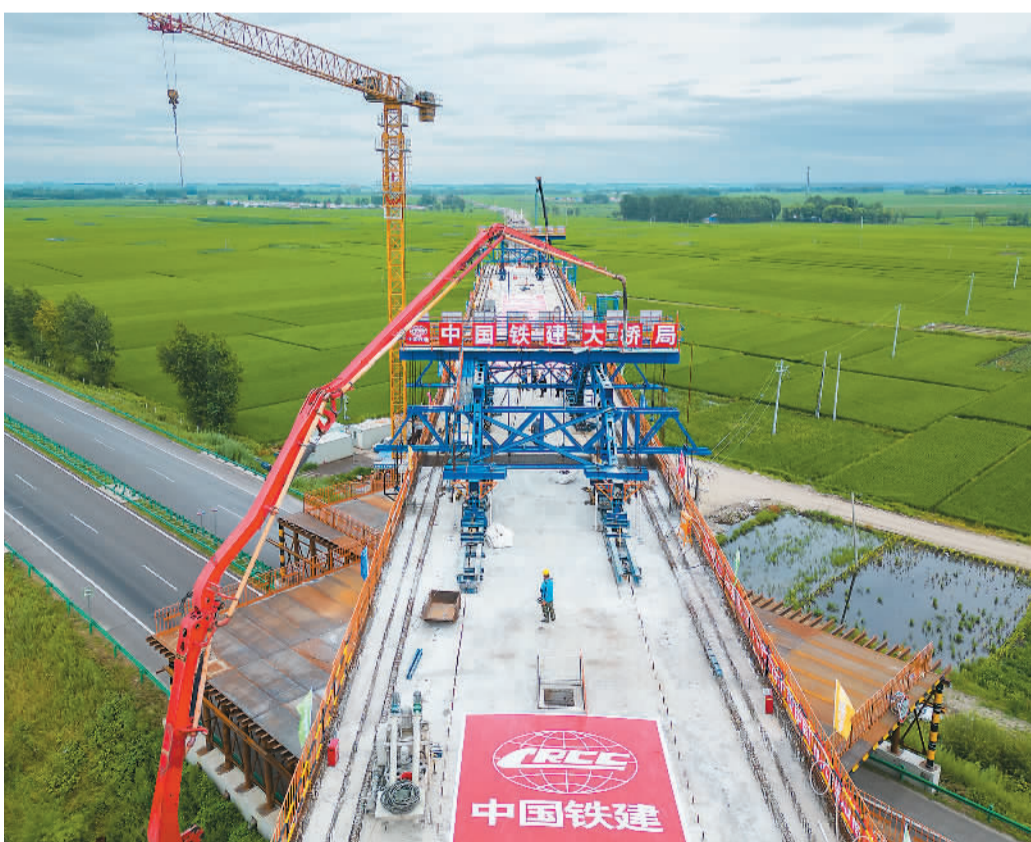
7月26日,位于黑龙江省庆安县的哈伊高铁哈尔滨至铁力段首个特大桥悬浇连续梁完成合龙,这标志着我国最北端在建高铁桥梁建设进入新阶段。 图为在哈伊高铁庆安安邦河特大桥施工现场,工作人员正在进行浇筑作业。 新华社记者 张涛摄
