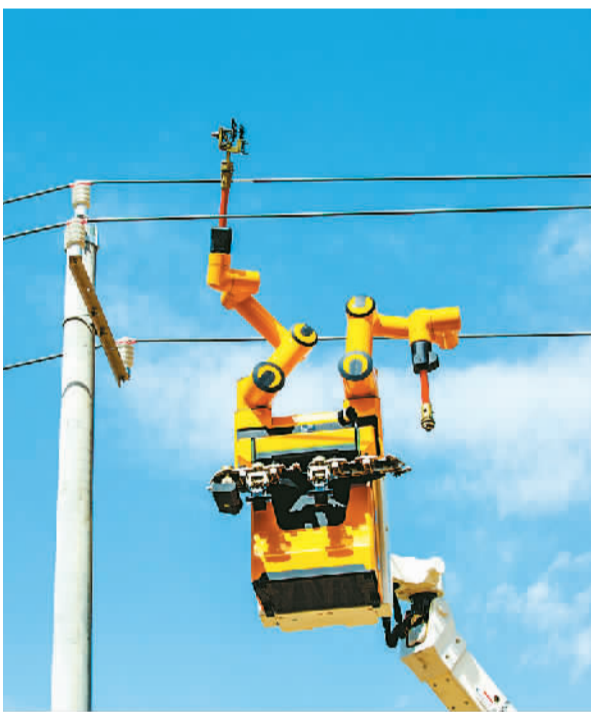
7月10日，甘肃省张掖市，国网甘肃张掖供电公司开展机器人带电安装验收接地环作业。 杨潇摄（人民图片）
