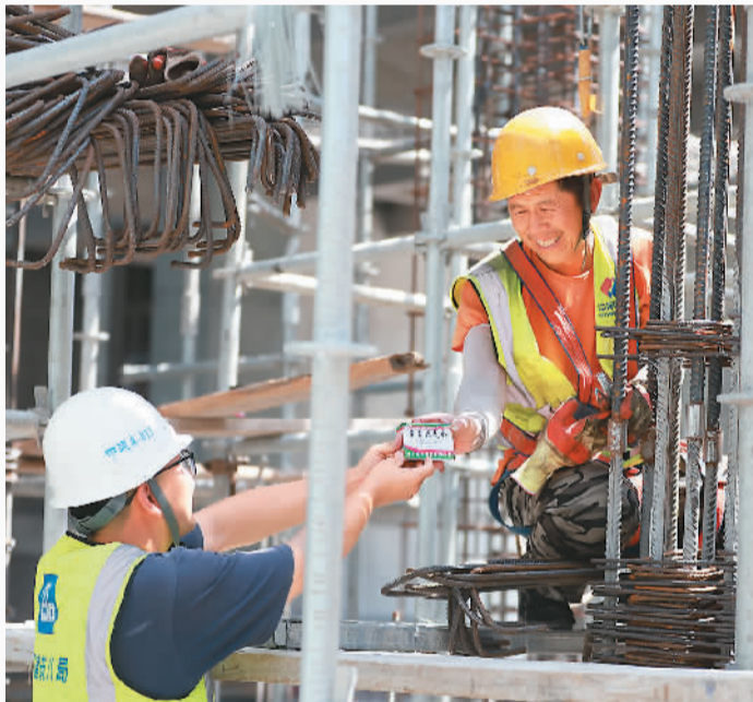
在中建八局二公司承建的济南长岭高科创新产业园项目上，项目部为一线工友送去藿香正气水等防暑降温物资，保障一线建设者度过高温天气。 孙裕泽摄
