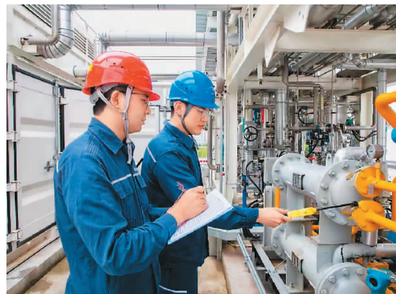
近日，中国首套自主研发的百千瓦级电氢双向转换装置在广州南沙小虎岛投入运营，标志着中国可逆固体氧化物电池技术从实验室走向示范应用。该装置由南方电网广东广州供电局研发，依托“电—氢”和“氢—电”的高效、双向转化优势，丰富了新型电力系统的调节资源，有助于粤港澳大湾区风电等新能源的大规模就近消纳，也为交通、工业等领域提供“绿氢”，助力各行业深度脱碳。图为工作人员对现场设备运行状态进行巡检。 龚 甸 摄
