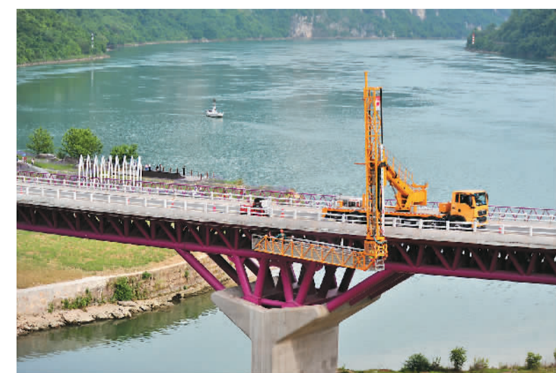
5月12日,专业技术人员对长江西陵峡畔的湖北省宜昌市夷陵区乐天溪镇莲沱畔大桥进行检查检测,形成“一桥一档”技术档案检查报告。张国荣摄(人民图片)
