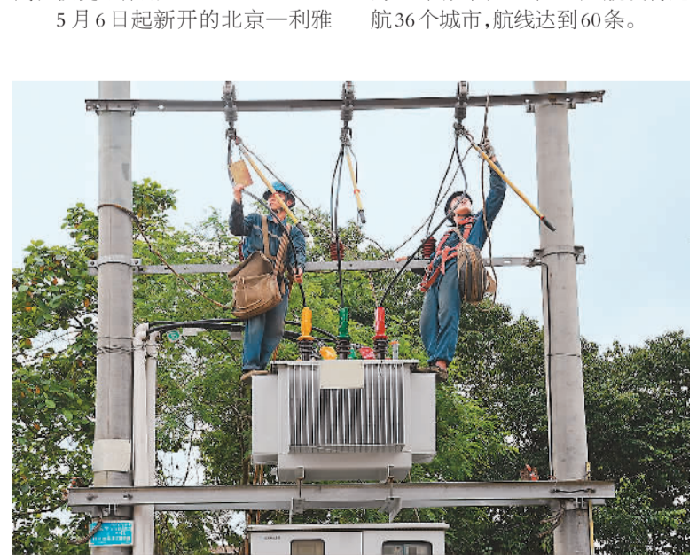
连日来，持续性强对流、强降雨天气对广东电力供应带来挑战。南方电网广东电网公司积极行动，累计出动人员17420人次，应急发电车140台，应急发电机113台，推动辖区电力供应尽快恢复，保障生产生活用电。图为南方电网广东清远英德供电局英红供电所工作人员在10千伏水头线云水谣谢屋村台区，开展受雷击损坏的变压器更换作业。 周志旺摄（人民视觉）
