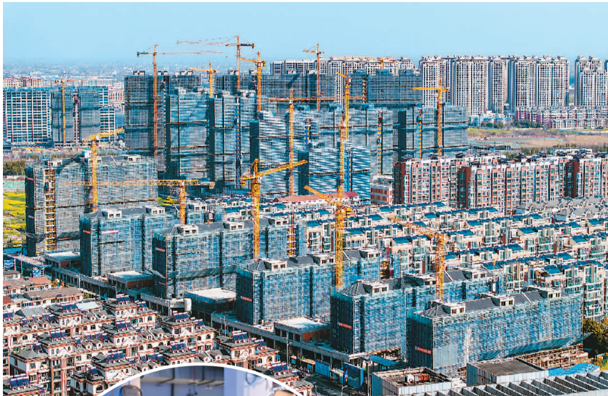
近期，江苏省海安市出台试行商品房“以旧换新”政策，计划今年实施商品房“以旧换新”100套。图为海安高新区的一处住宅项目正在施工。
