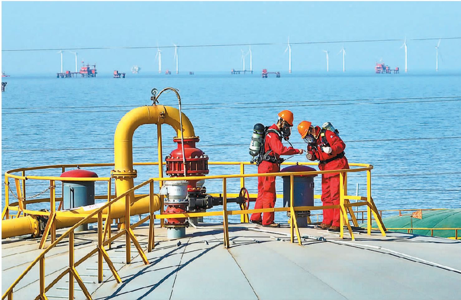
▲3月19日，在位于山东省东营市的胜利油田海四联合站，员工对储油罐顶部液压安全阀和机械呼吸阀进行维护，避免甲烷等气体外排造成大气污染。胜利油田高标准落实黄河流域生态环境保护专项整治措施，开展“无废油田”和绿色工厂创建，实现了石油开采、管输和储存的全过程绿色清洁生产。王国章摄（人民日报）
