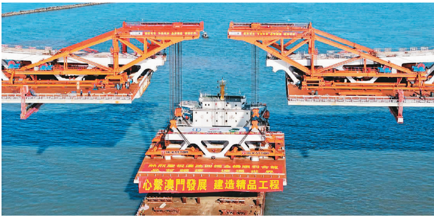
近日，澳门半岛至氹仔的第四条跨海大桥顺利实现全桥合龙，标志着项目由主体结构工程全面迈入桥梁附属结构工程。该桥主线全长3.085公里，其中跨海段长约2.9公里，设置通航孔桥两座，跨度达280米。大桥开通后，将有效缓解现有三座大桥的交通压力，提高澳门半岛与氹仔、路环之间的交通通行能力，并配合新城填海A区发展的交通需求。图为第四条澳氹跨海大桥施工现场。 （新华社发）
