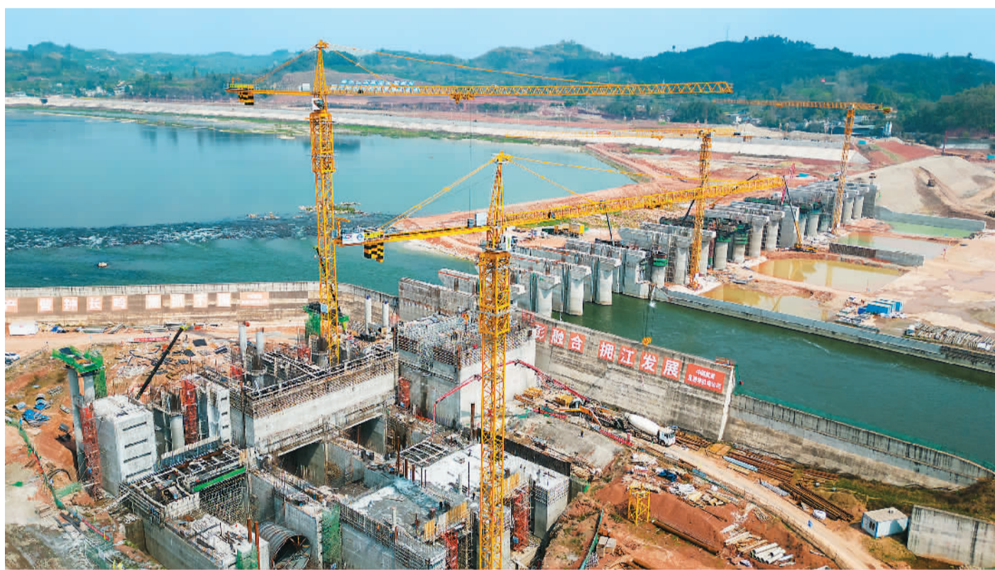
岷江彭山尖子山航电枢纽工程位于四川省眉山市，该项目是以航运为主、航电结合，兼顾水环境综合整治和防洪等功能的水利枢纽。图为3月13日，项目施工现场。 翁光摄（人民视觉）
