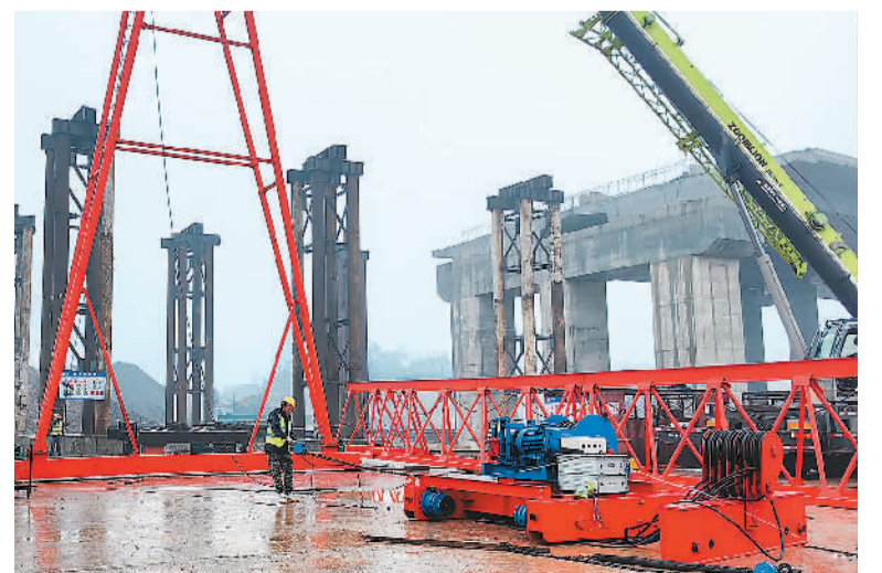
伶俐大桥项目是广西南宁市重要民生工程，大桥路线总长1.969公里，由中建路桥集团有限公司承建。项目建成后将打通南宁市青秀区伶俐镇邕江南岸交通，进一步完善南宁市区域路网布局。图为项目施工现场，工人正在有序施工。韩豪哲摄（人民视觉）
