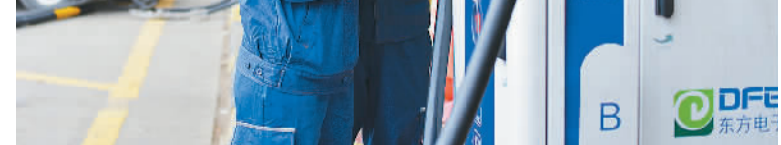
春运期间，南方电网广东电网公司精心安排，做好新能源汽车充电保障工作，助力绿色出行。2023年，该公司在2022年实现充电桩乡镇全覆盖的基础上，新建充电桩4459个，累计投运超3.5万个。图为南方电网广东佛山顺德供电局工作人员对广州绕城高速公路服务区充电桩进行专项检查。 龙子骥摄（人民视觉）
