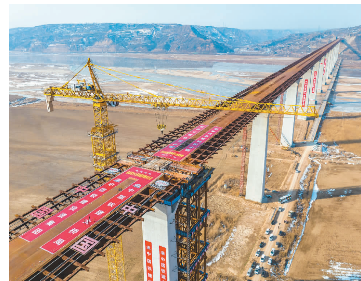
1月26日，临猗黄河大桥主桥钢箱梁在山西省运城市顺利合龙。该桥全长5427米，主桥采用等高度连续钢箱组合梁，从山西、陕西两侧顶推平台对向顶推施工，是国家高速公路菏宝线G3511的控制性节点工程。图为大桥合龙现场。薛俊摄（人民视觉）
