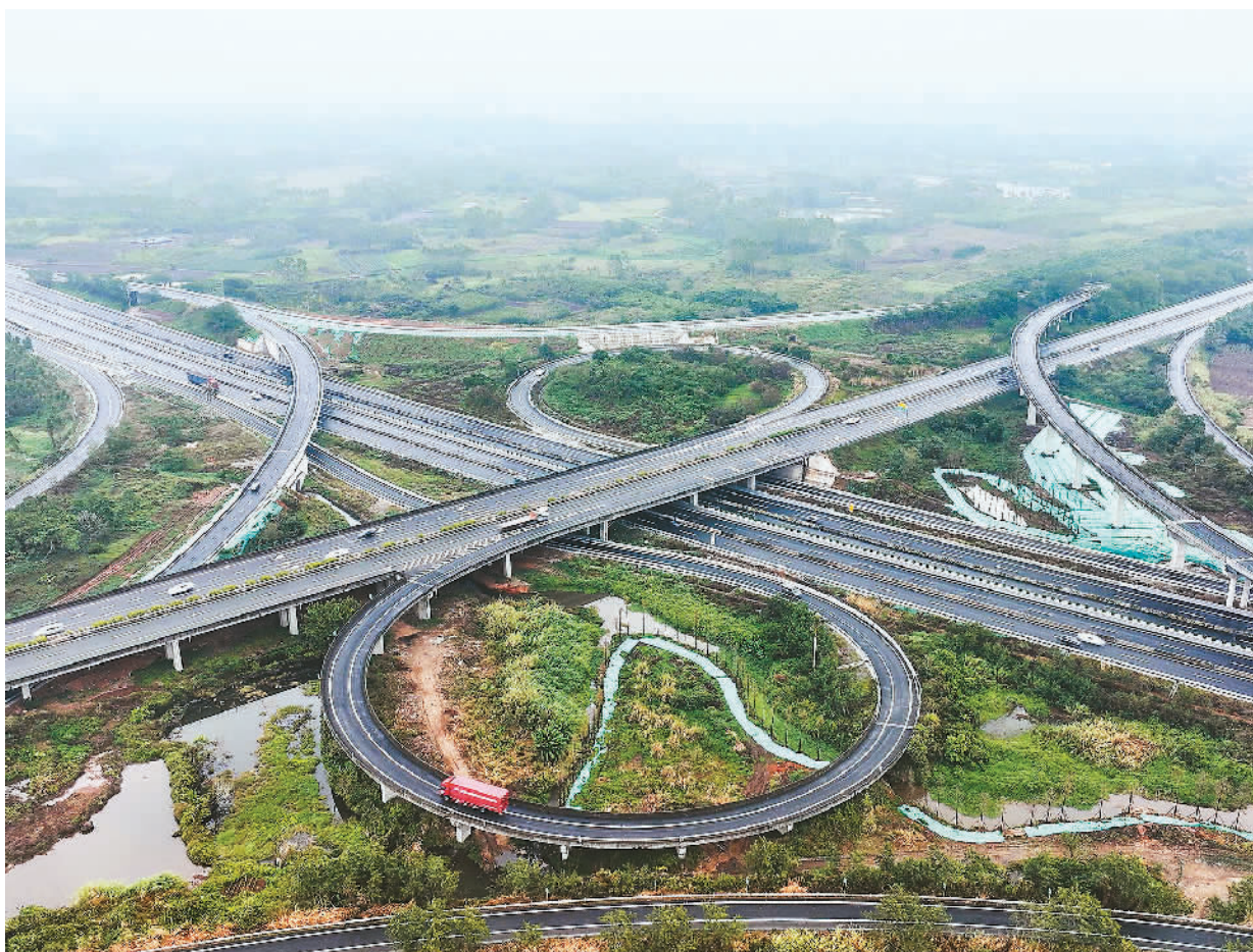
沈海国家高速茂湛段改扩建工程临近收官。该项目位于雷州半岛,起于广东省茂名市电白区,终于广东省湛江市麻章区,全长约108.6公里,将原双向4车道扩建为双向8车道,大幅提升路段通行能力,保障春运畅通。图为位于湛江市遂溪县东坡岭枢纽,是沈海和兰海两条国家高速公路的交汇点。
