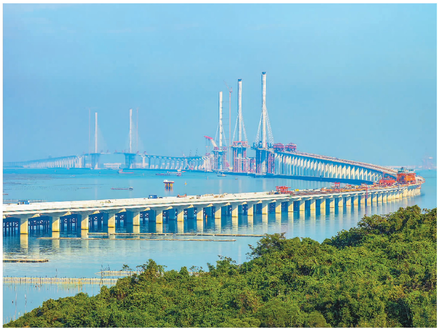
近日，黄茅海跨海通道中引桥顺利合龙，该项目两座海上主桥——黄茅海大桥与高栏港大桥成功完成海上“牵手”。黄茅海跨海通道连接广东省珠海市和江门市，建成通车后将成继港珠澳大桥、深中通道后，粤港澳大湾区第三条重要跨海通道。图为黄茅海跨海通道建设现场。中新社发
