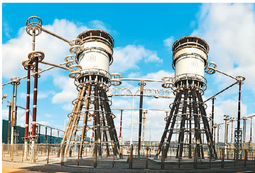
云南至广东±800千伏特高压直流输电示范工程楚雄换流站直流场设备。
