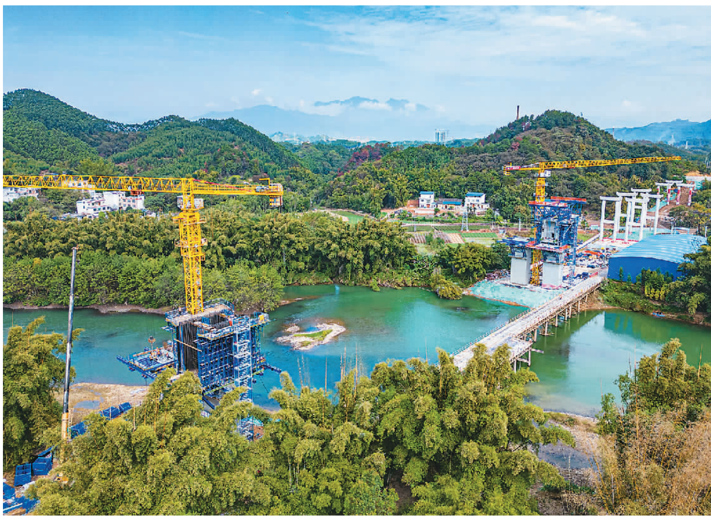
连日来，在广东连山至广西贺州高速公路项目贺江特大桥建设现场，施工单位抢抓有利天气，加紧施工作业。连山至贺州高速公路（广西段）项目主线全长49.5公里，建成后将进一步完善广西高速公路网络，构建连通粤港澳大湾区新通道。黎豪图摄（人民视觉）
