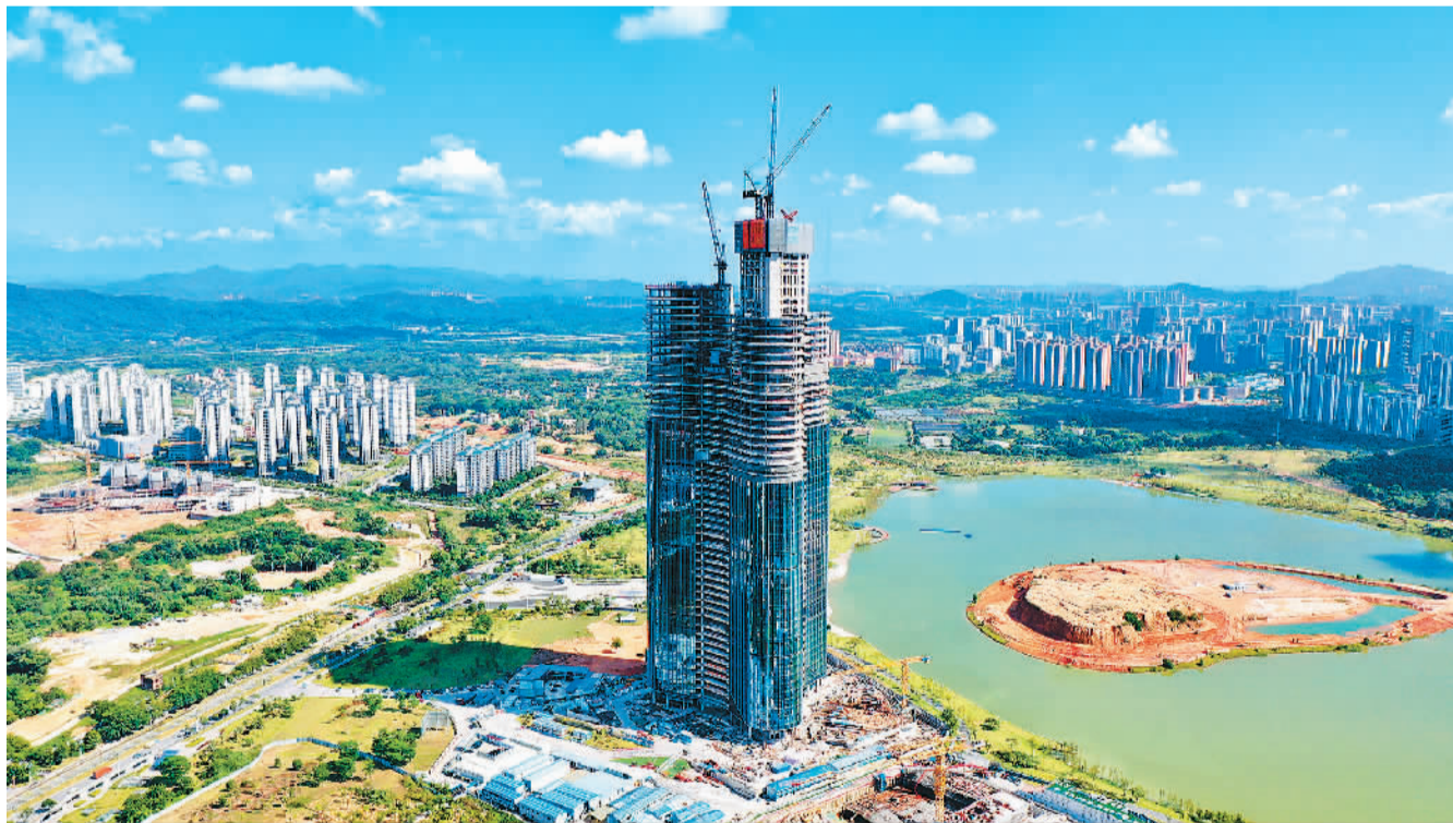
近日，中新广州知识城知识塔项目主体结构封顶。该项目位于广东省广州市，塔楼建筑高度302米，地上53层，地下5层，集办公、酒店、商业于一体，由中建八局华南公司承建。项目建成后将成为广州乃至粤港澳大湾区在科技创新、城市建设、招商引资等领域合作的重要载体，对粤港澳大湾区经济发展有助推作用。图为项目建设现场。
