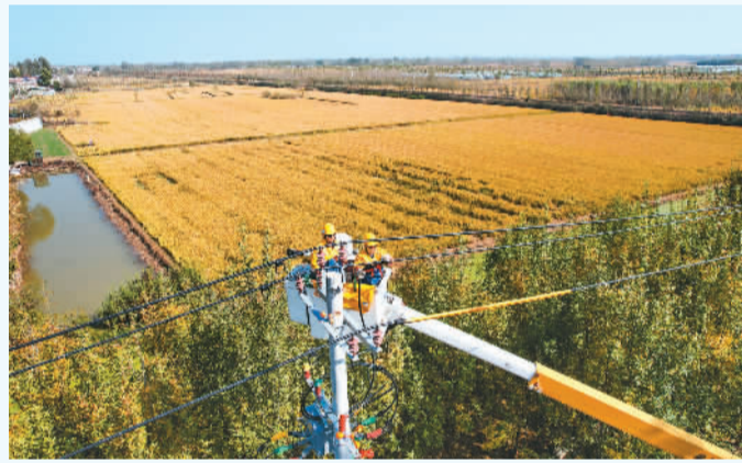
山东省济宁市任城区实施“生态农业”及“乡村旅游”双轮驱动战略，推动一二三产业融合发展，在喻屯镇，打造“滨湖水乡”乡村振兴示范片区，实施道路铺装、雨污分流、污水治理、绿化栽植、路灯亮化等人居环境整治工程。国网济宁市任城区供电公司以世界一流企业标准参与当地人居环境整治工程建设，提升供电服务质量，完成7处路灯变压器送电工作。图为国网济宁市任城区供电公司10千伏输电线路开展带电作业。东海摄
