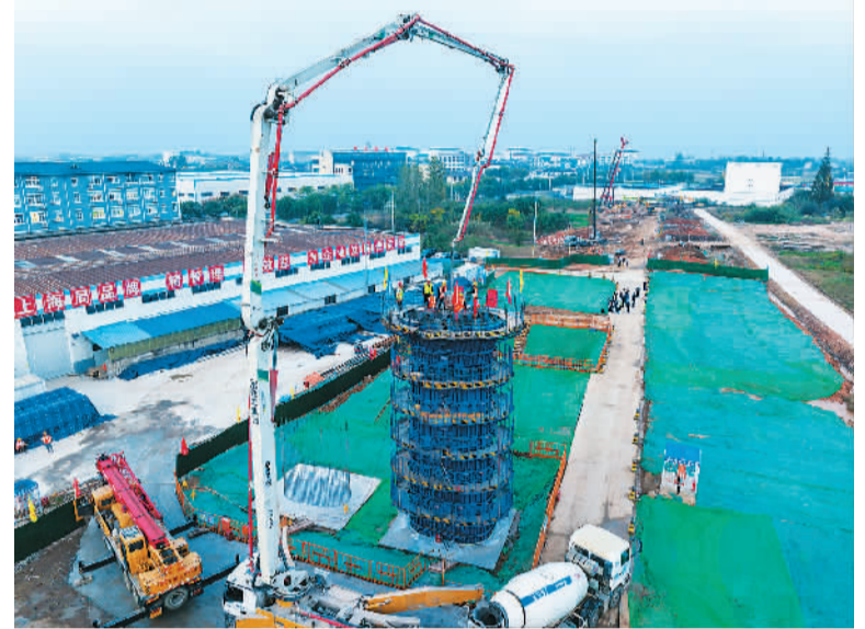
近日，由中铁上海工程局承建的宁淮城际铁路六合特大桥首个墩身顺利浇筑完成，标志着宁淮城际铁路南京段主体工程建设取得突破性进展。宁淮城际铁路新建线路全长179公里，设计时速350公里。该铁路项目建成运营后，将进一步完善江苏省内城际轨道交通网布局，促进南京市和沿线苏皖地区经济社会发展。
